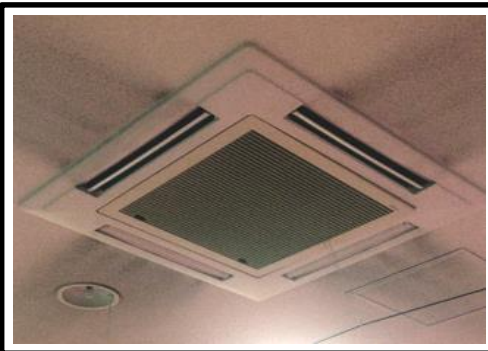
古いエアコンが多く、 故障が多くなってきた・・・
