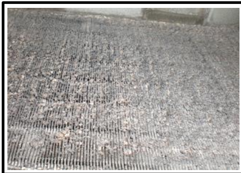
既存のエアコンの能力が 不足、足りていない・・・
