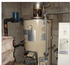
古くなった給湯ボイラー
