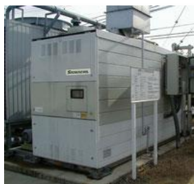
古くなった空調システム
