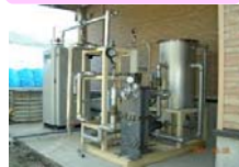
ボイラー・給湯器
