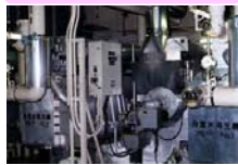
冷温水発生機
